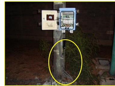
Caja con cableado hacia vías
