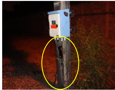
Caja con cableado hacia las vías
